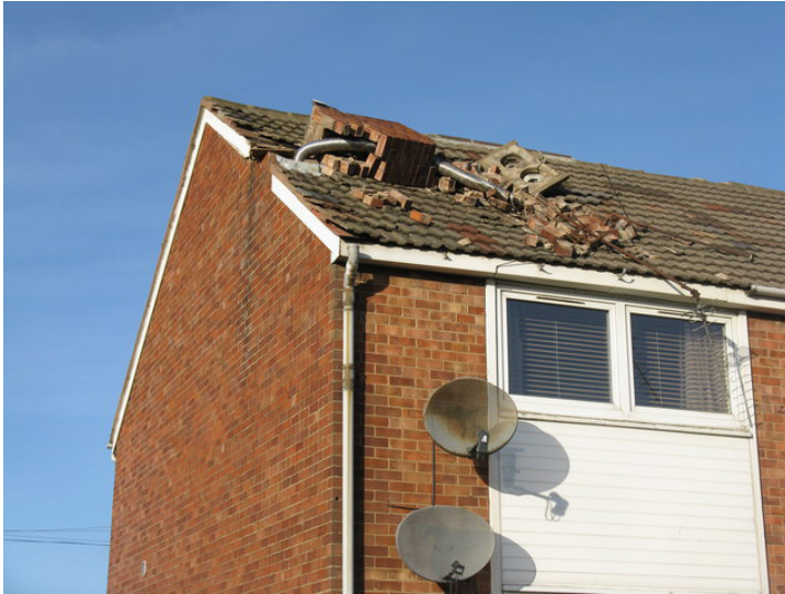
Bâtiment endommagé par une tempête (Edimbourg, Grande-Bretagne)
